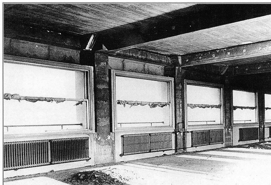
1959 - Construction de l'Hôtel-Dieu. L'intérieur du service à l'état brut. Encore des années de travaux, et surtout d'atermoiements, avant son ouverture
