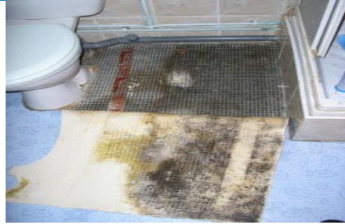
Contamination de l'envers du revêtement de sol et du carrelage dans des sanitaires. Cause : Fuite de canalisations
