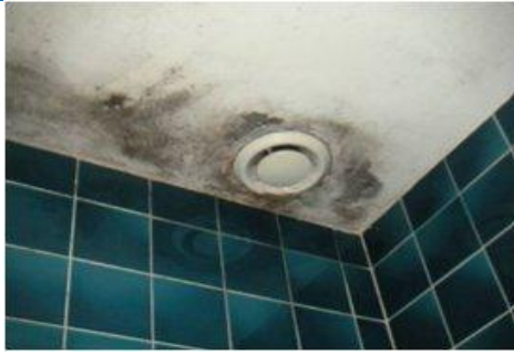
Contamination dans une salle de bain autour de la bouche d'extraction non fonctionnelle Cause : Défaut de ventilation et phénomènes de condensation
