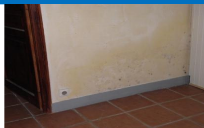
Mur contaminé au niveau de la zone froide
