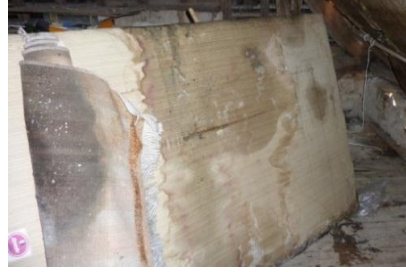
Dégradation d'un matelas
